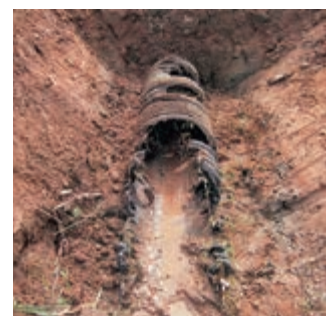
野焼きにより焼失した埋設管
