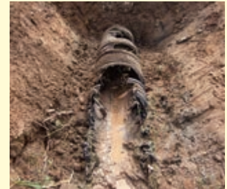
野焼きにより焼失した埋設管
