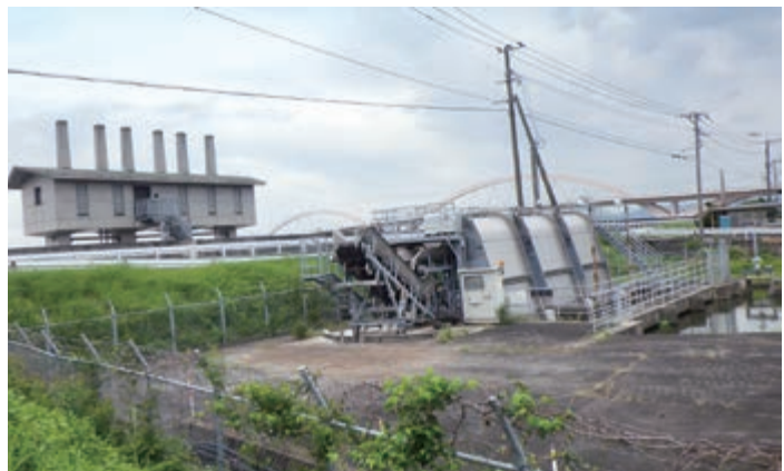
排水路末端に設置されているロータリーレーキ式除塵機
